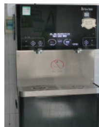
各楼层及宿舍安装节能净水器
