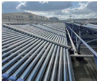
公司安装的太阳能热水器
