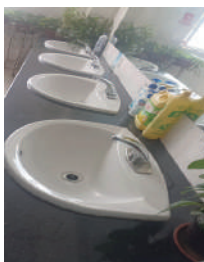
卫生间安装感应水龙头
